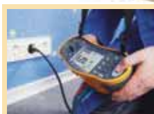
Testowanie instalacji elektrycznych
